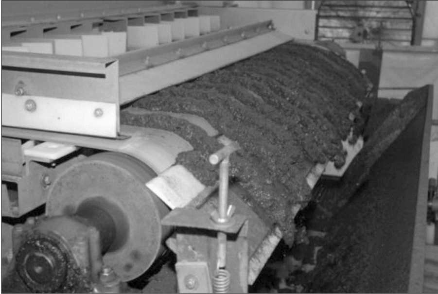
الشكل (10-10): صورة واقعية للنابذ وتظهر عليه الحمأة
