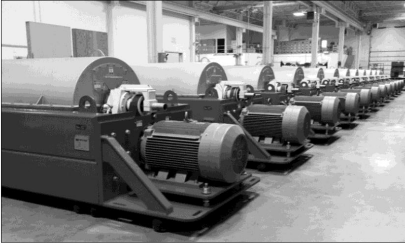
الشكل (10-11): يظهر محطة نزع المياه من الحمأة بالطريقة الطرد المركزي أو النبذ
