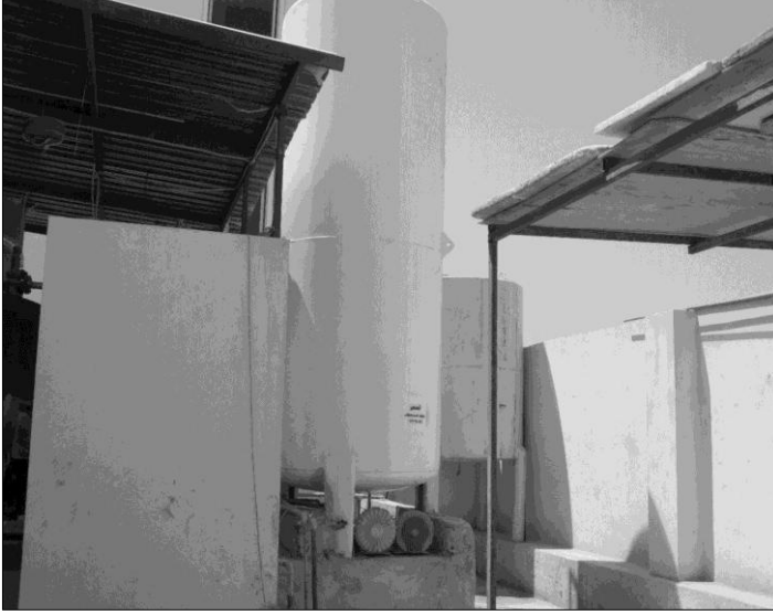
الشكل (6-25): صورة فوتوغرافية تظهر مفاعل UASB
