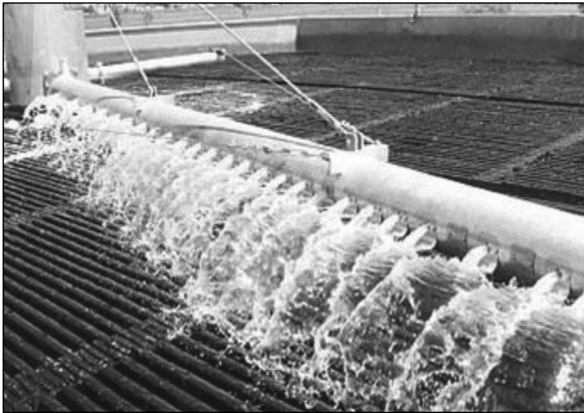
الشكل (7-29): يبين الزراع الدوارة التي تنشر المياه فوق المرشح
